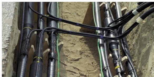
Figura 9 - emendas seccionadas num sistema cross-bonding. Os cabos que saem da emenda em direção ao lado direito da foto estão conectados as blindagens e são conduzidos a uma link-box.
